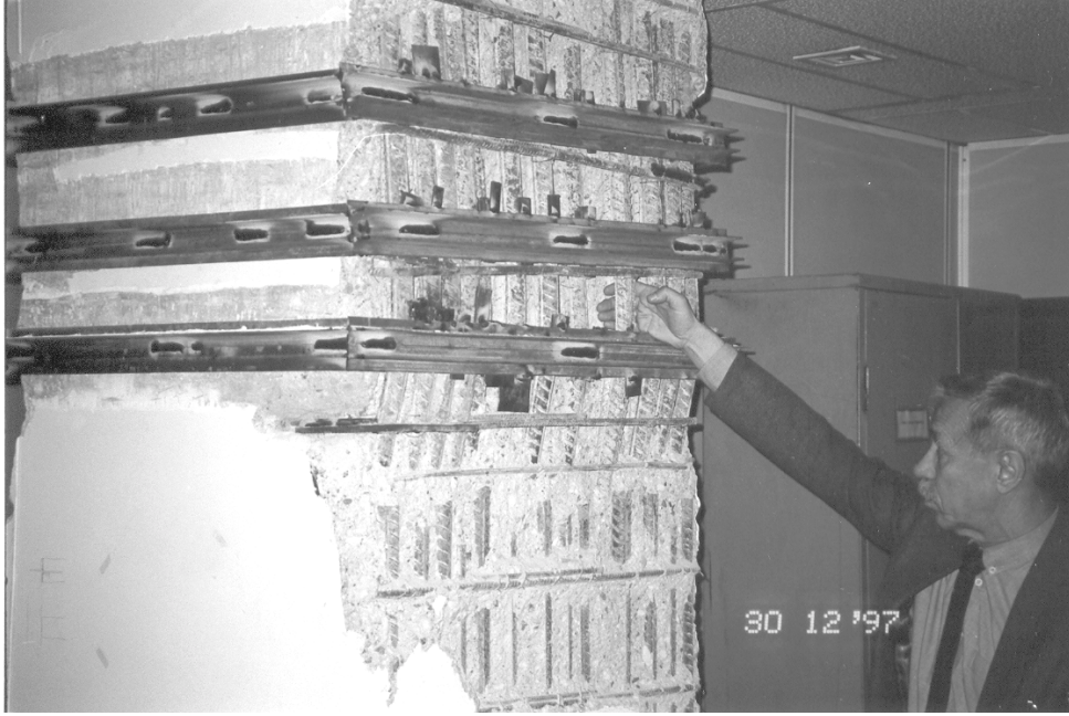
Şekil 4.15 Hasar gören kolon
